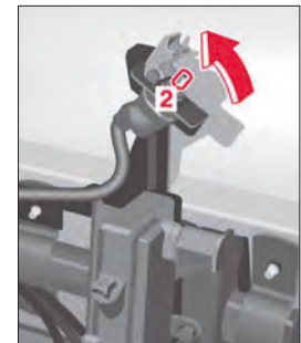
Imagen 121. Posible disposición del interruptor de desconexión de emergencia, a la derecha, detrás de la cabina
