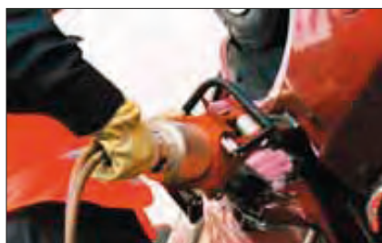
Imagen 232. Separación de la puerta de su estructura
