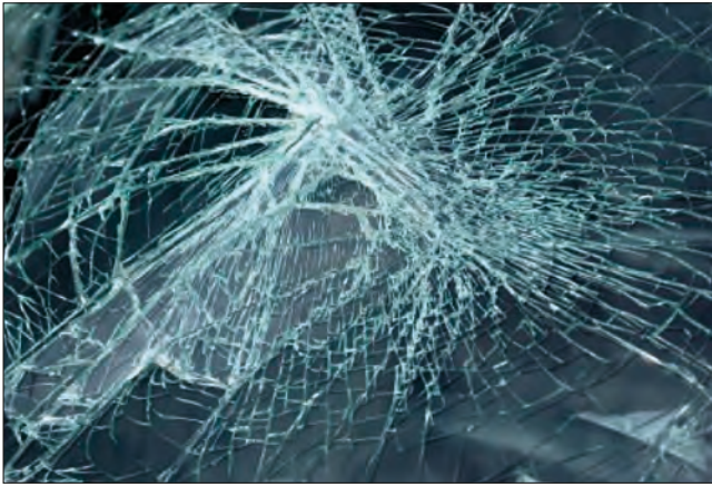
Imagen 75. Rotura de luna laminada
