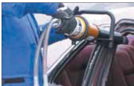
Imagen 221. Corte en la parte superior del pilar B
