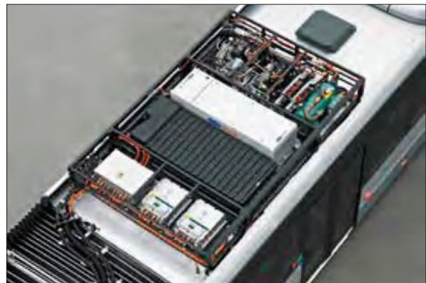
Imagen 42. Grupos auxiliares de accionamiento eléctrico y baterías
