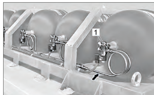
Imagen 136. Tanques de gas
