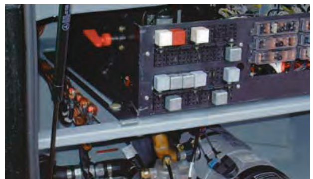
Imagen 127. Desconector acoplado a la caja de fusibles
