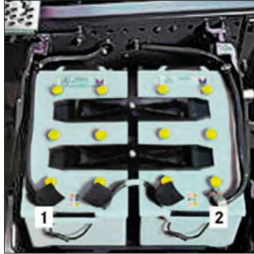
Imagen 122. Caja de baterías en el lado del conductor (1) Polo Positivo, (2) Polo Negativo
