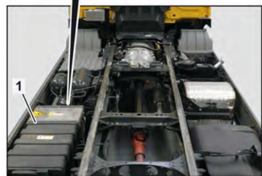
Imagen 126. Interruptor (2) de desconexión de baterías (1)
