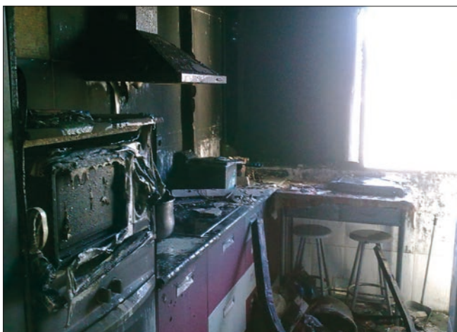
Imagen 35. Incendio de contenido. Estructura de obra de fábrica y forjados de hormigón
