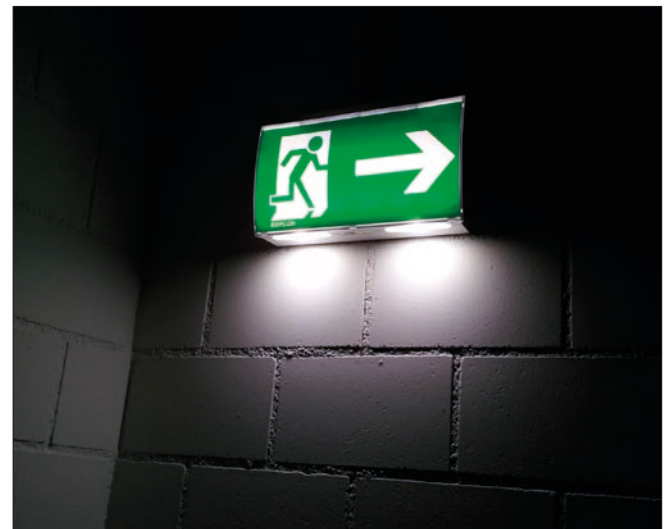
Imagen 11. Salida de emergencia
