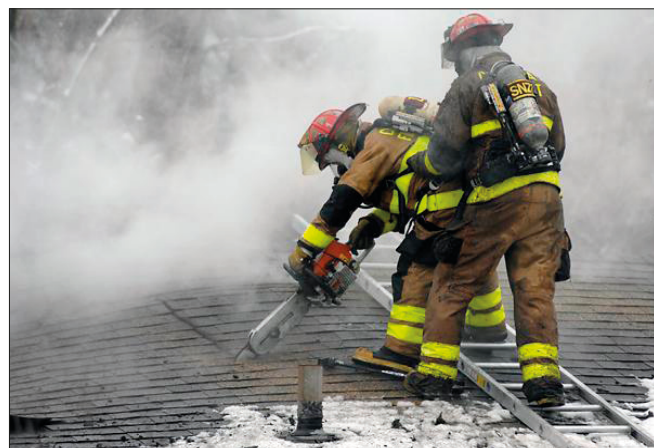
Imagen 108. Ventilación natural en cubierta
