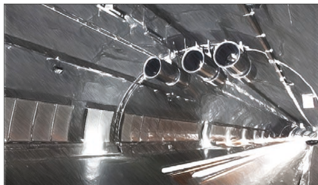
Imagen 13. Ventiladores en túnel
