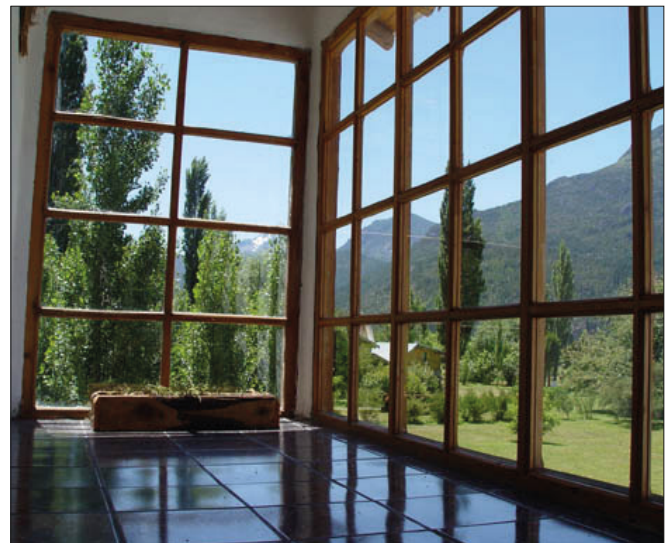
Imagen 169: Ventanales de gran tamaño implican una potencial ventilación del incendio en caso de rotura
